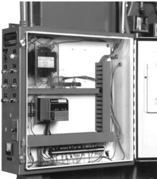
Abb. 7. Installation im Schaltschrank.
