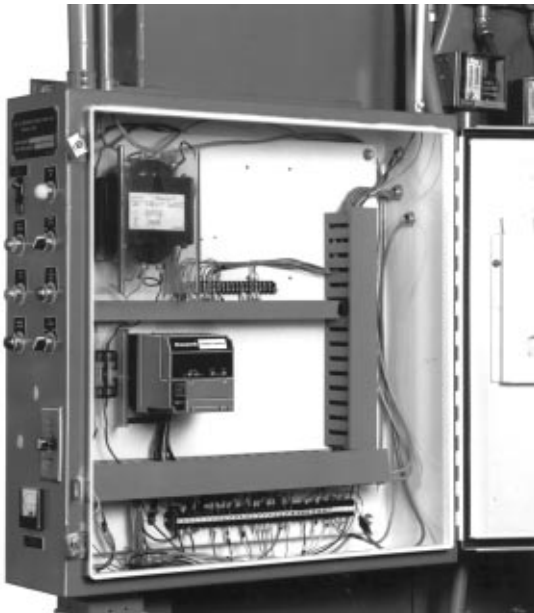
Fig. 7. Installation dans armoire électrique.
